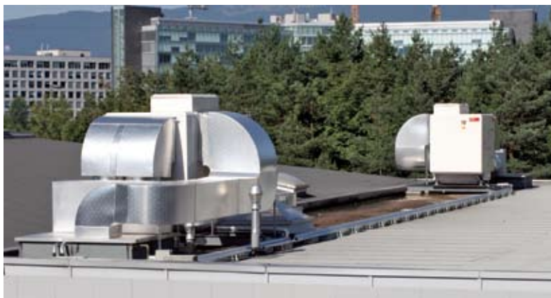
Stílusos gyárépület Hoval AdiaVent®-tel
