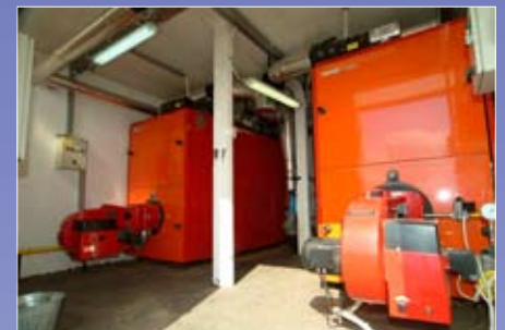
MOL Rt. (Zsana) 4 MW-os kazánkonténer 2 db Hoval ST Plus 2000 melegvíz kazán
