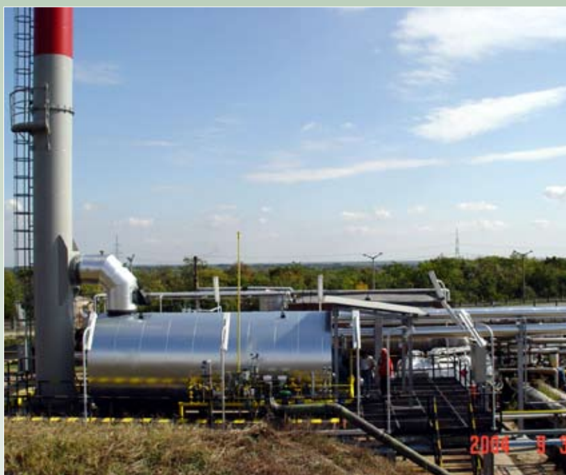
MOL-DUFI • 11,5 MW teljesítményű thermoolajkazán • Százhalombatta
