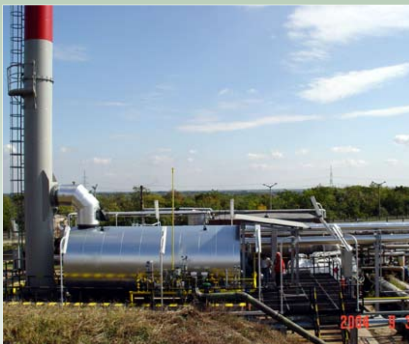
MOL-DUFI • 11,5 MW teljesítményű thermoolajkazán • Százhalombatta
